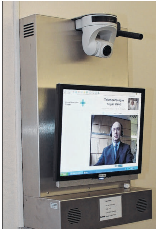
Diese Telekommunikationseinheit an der Wand in einem Dinkelsbühler Krankenzimmer kann Leben retten. Nach 90 Sekunden steht die Verbindung zu einem Neurologen.
